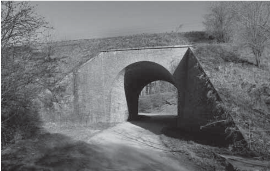
Ryc. 29. Ceglany wiadukt sklepiony w Rosnówku (99. km linii) należy do największych tego typu obiektów linii, 2011
