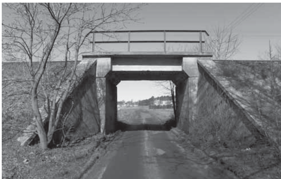
Ryc. 27. Przykład wiaduktu żelbetowego (żelbetowe są również przyczółki i ich skrzydła), powszechnie stosowanego podczas budowy na linii Wolsztyn – Luboń, (56. km linii), 2011
