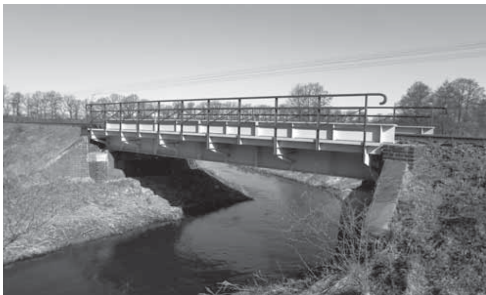
Ryc. 28. Blachownicowy most nad rzeką Mogilnicą (Ptaszkowo) pierwotnie wsparty na ceglanych przyczółkach. Obecnie most posiada nowe przęsło, wykonane techniką spawania, 2011
