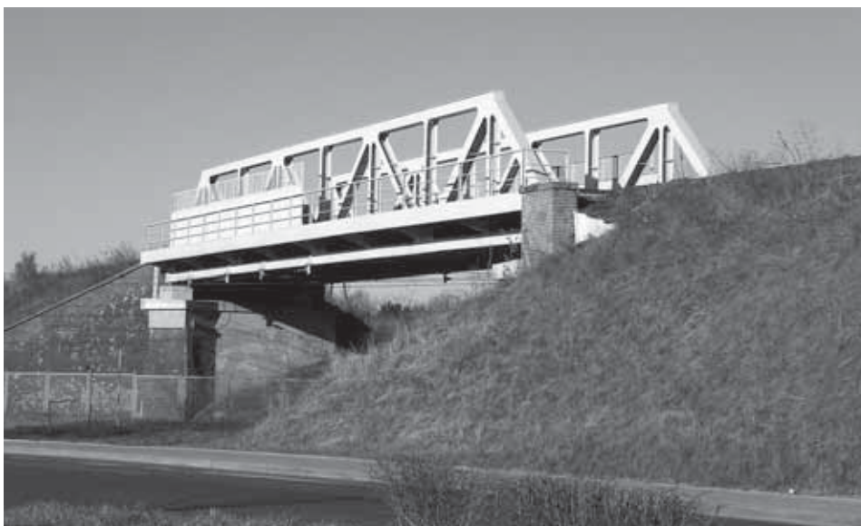
Ryc. 31. Kratownicowy wiadukt nad koleją Poznań – Wrocław (35 m szer. w świetle) posadzono na ceglanych przyczółkach, typowych dla budownictwa kolejowego Prus początku XX w. Obecnie wiadukt posiada współczesne, spawane przeszło, 2011
